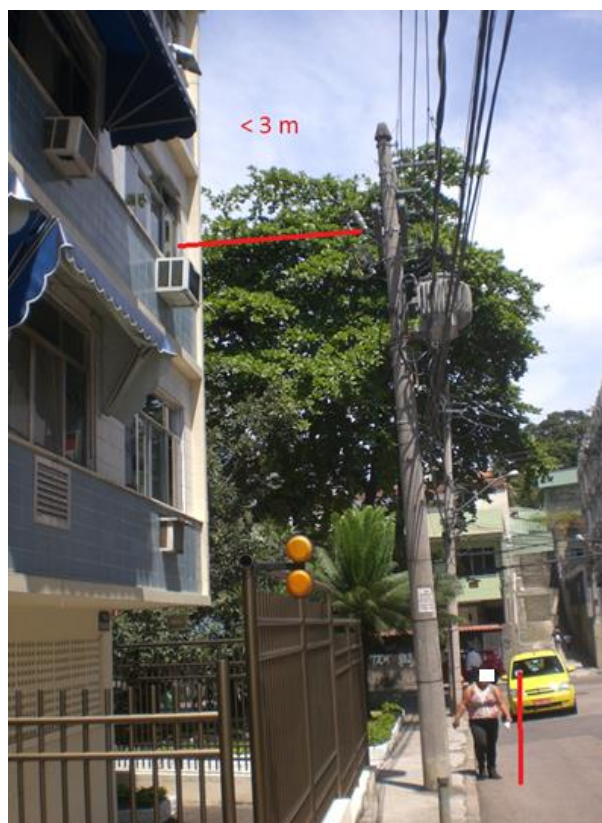
Figura 3 - Un fusible tipo expulsión IEC 60282-2 instalado muy cerca de una ventana residencial
